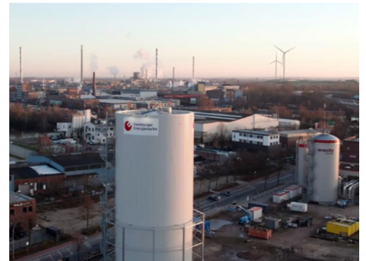
Warmwasserpufferspeicher der Hamburger Energiewerke
