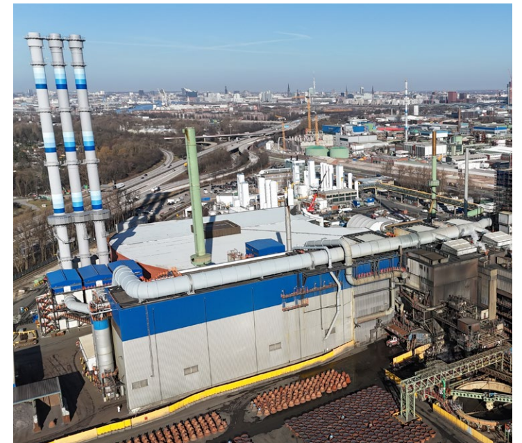
Blick auf das neue Abluftsystem am Standort Hamburg in unmittelbarer Stadtnähe
