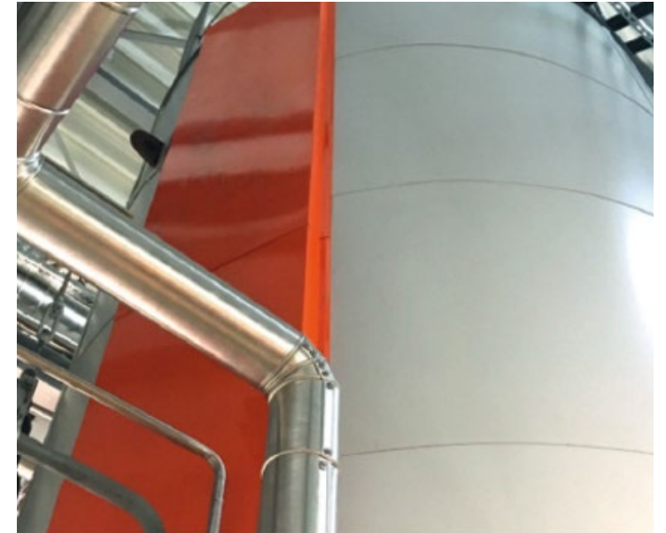
Neue Power-to-Steam-Anlage im Werk Hamburg
